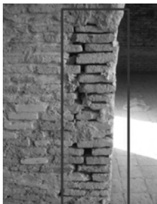
نمونه‌هایی از فرسایش در بنای مسجد
